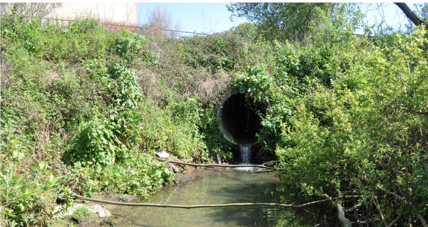
Manilha de passagem hidráulica. Abril, 2016
